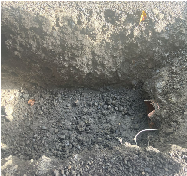
Figure 1 : Photo du collecteur des eaux pluviales interrompu
